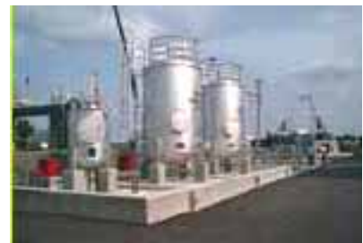
沖縄県宮古島の油槽所
